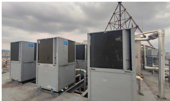
改造后的空气源热泵热水系统
